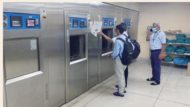
ネパール：トリブバン大学教育病院 高圧蒸気滅菌器
